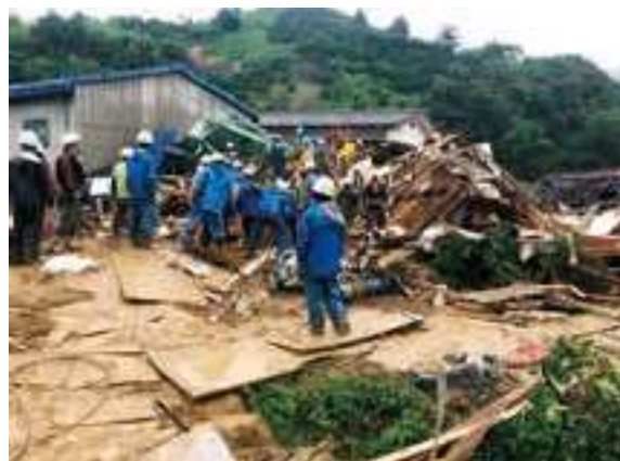
大雨による土砂崩れ現場での活動
